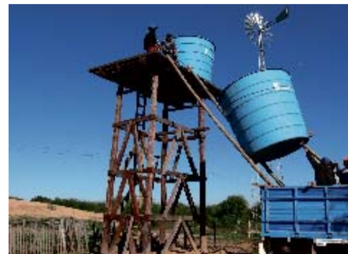
Paraguay, cisterne per l'accumulo d'acqua
